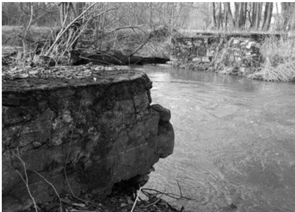
Minięta – zniszczona tama na rzece Dzierzgoń, fot. A. Langowski
