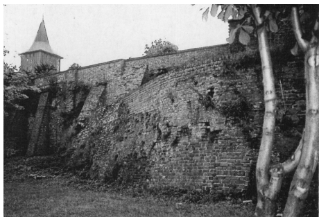
Mur otaczający ruiny Szkoły Łacińskiej od Nogatu, dobrze widoczne zniszczenia
